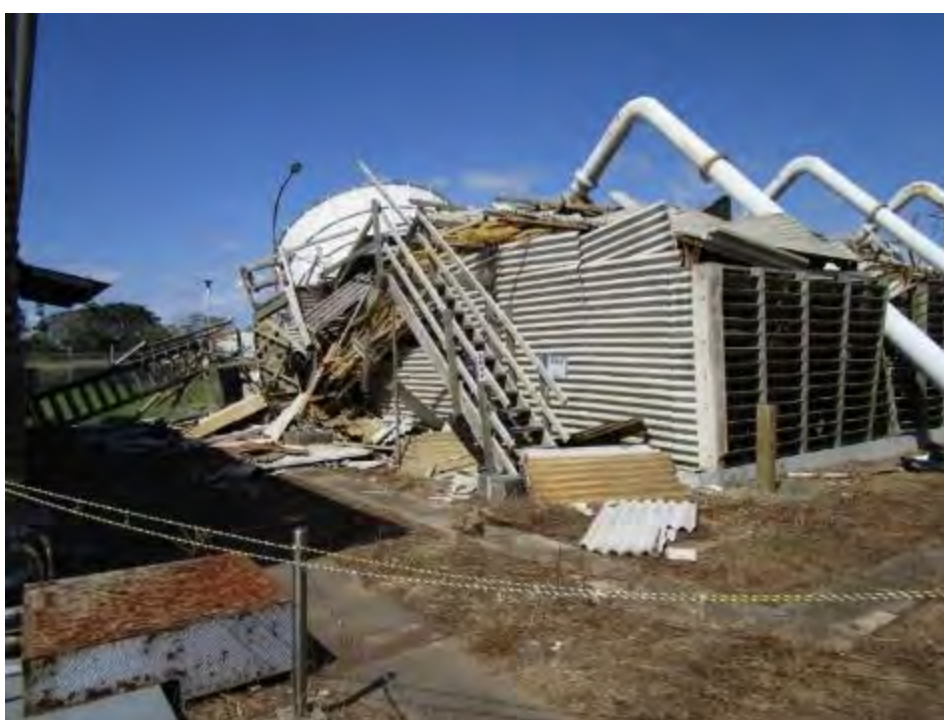
写真⑥ 倒壊後 南側（令和元年9月12日撮影）
