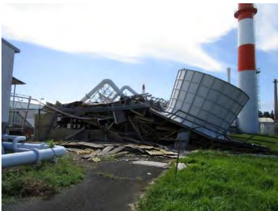
写真⑤ 倒壊後 北側（令和元年9月12日撮影）
