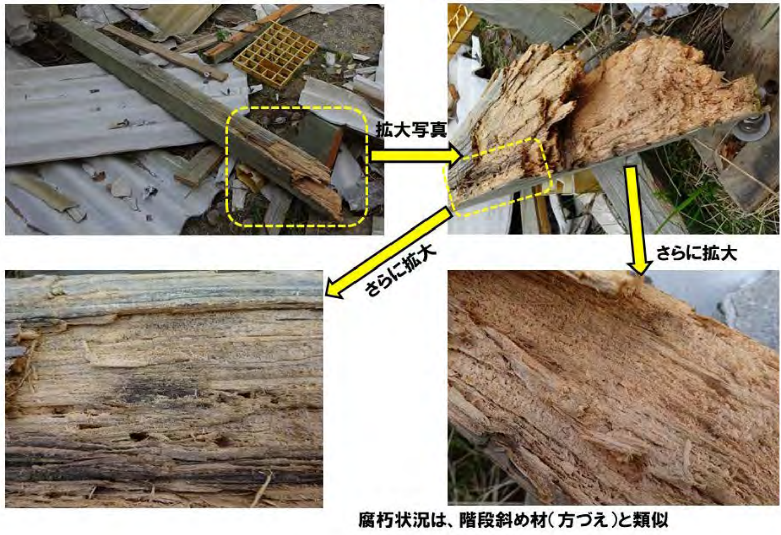
図④-6 南面の柱の木材の状態
