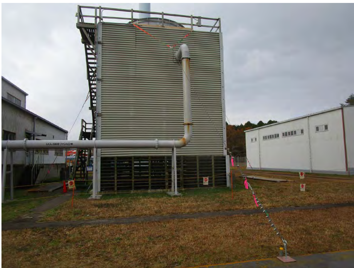
図7 UCL 系統冷却塔：ワイヤーロープによる固定（令和元年11月25日撮影）
