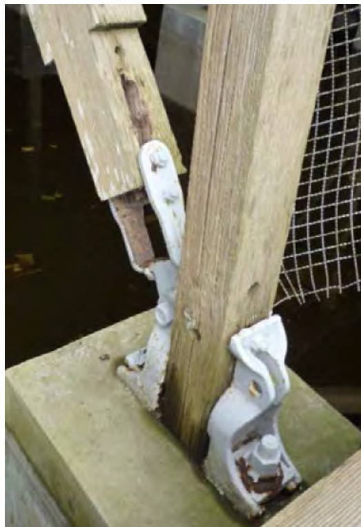
図⑤-4 接合ボルト穴の周囲の劣化状態
