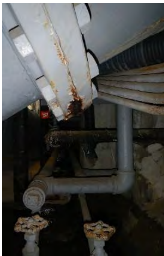
写真② 二次冷却系配管 止水後 (令和元年9月9日撮影)
