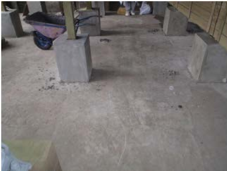
図①-3 基礎部ひび割れ補修前の写真
